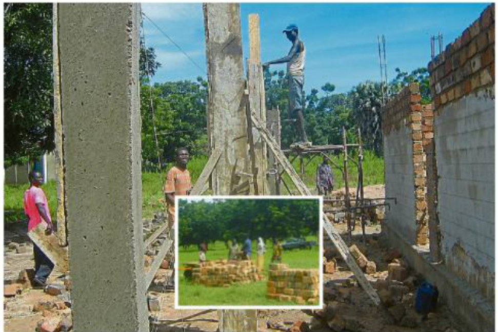
Die Mauern für die Schulkantine wachsen, die Dorfbewohner haben dafür die Steine produziert und sie tagelang angeliefert.
